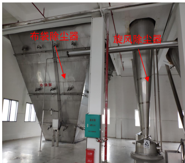
干燥废气处理设施
