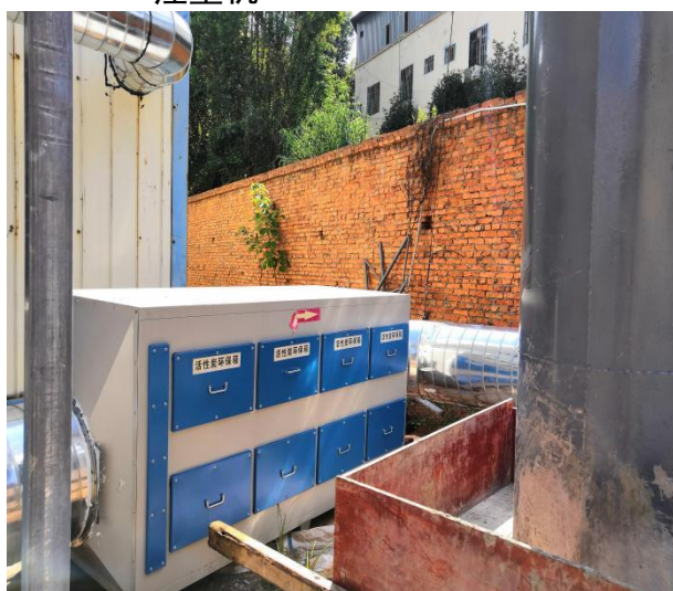
废气处理设施（活性炭吸附箱）
