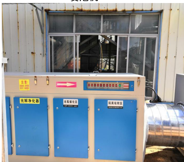
废气处理设施（光解净化器）
