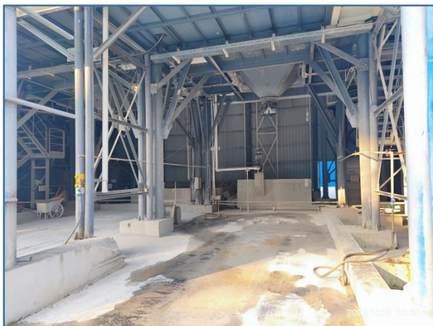
混凝土装车区
