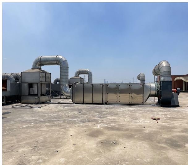
废气处理设施
