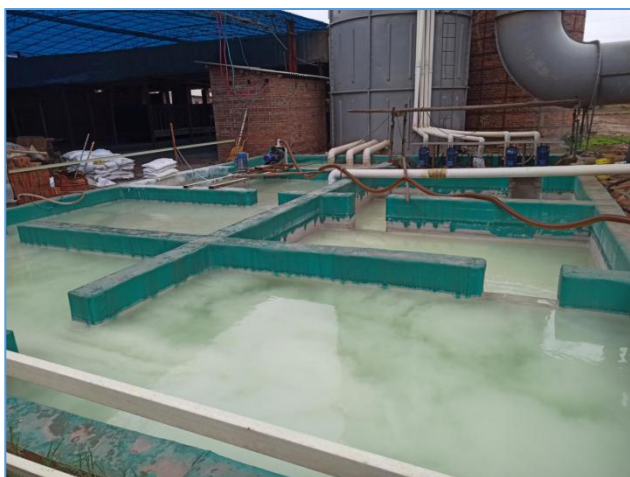
脱硫废水循环池
