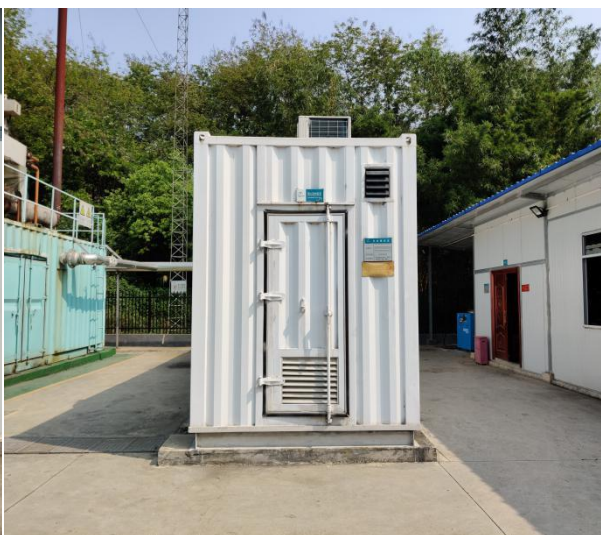
沼气预处理系统控制室
